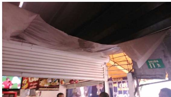
Mercado Belisario Domínguez, lo locatarios colocan lonas para no mojarse.
