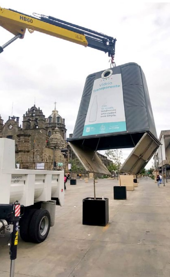
Imagen 26. Sistemas de elevación y vaciado instalados en los "contenedores" de acopio de vidrio. (DMA, 2021)
