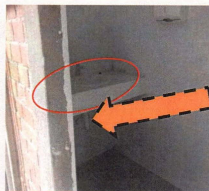
Imagen de referencia tomada el 24 enero de 2023, en área de baños donde se verifica el suministro y colocación de 8 lavabos, con diferentes especificaciones al proyecto.
