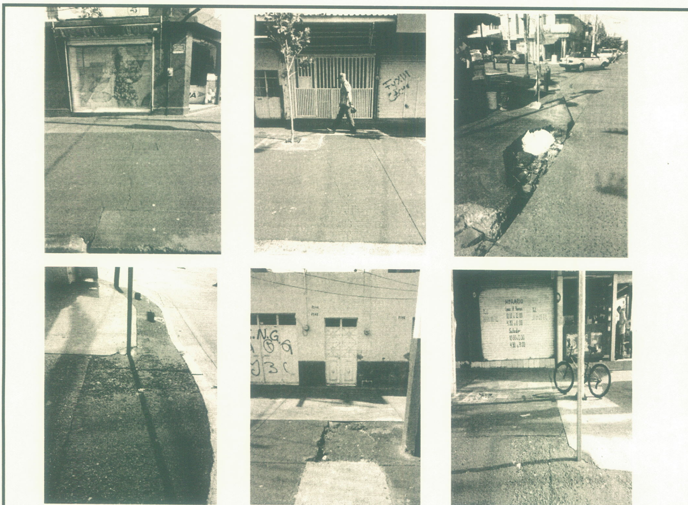
En las presentes fotografías se puede apreciar las losas de concreto en las banquetas que presentan grietas o desgaste prematuro por mala calidad en los materiales o mano de obra, motivo por el que se hizo la observación a los conceptos 90 y 100.
